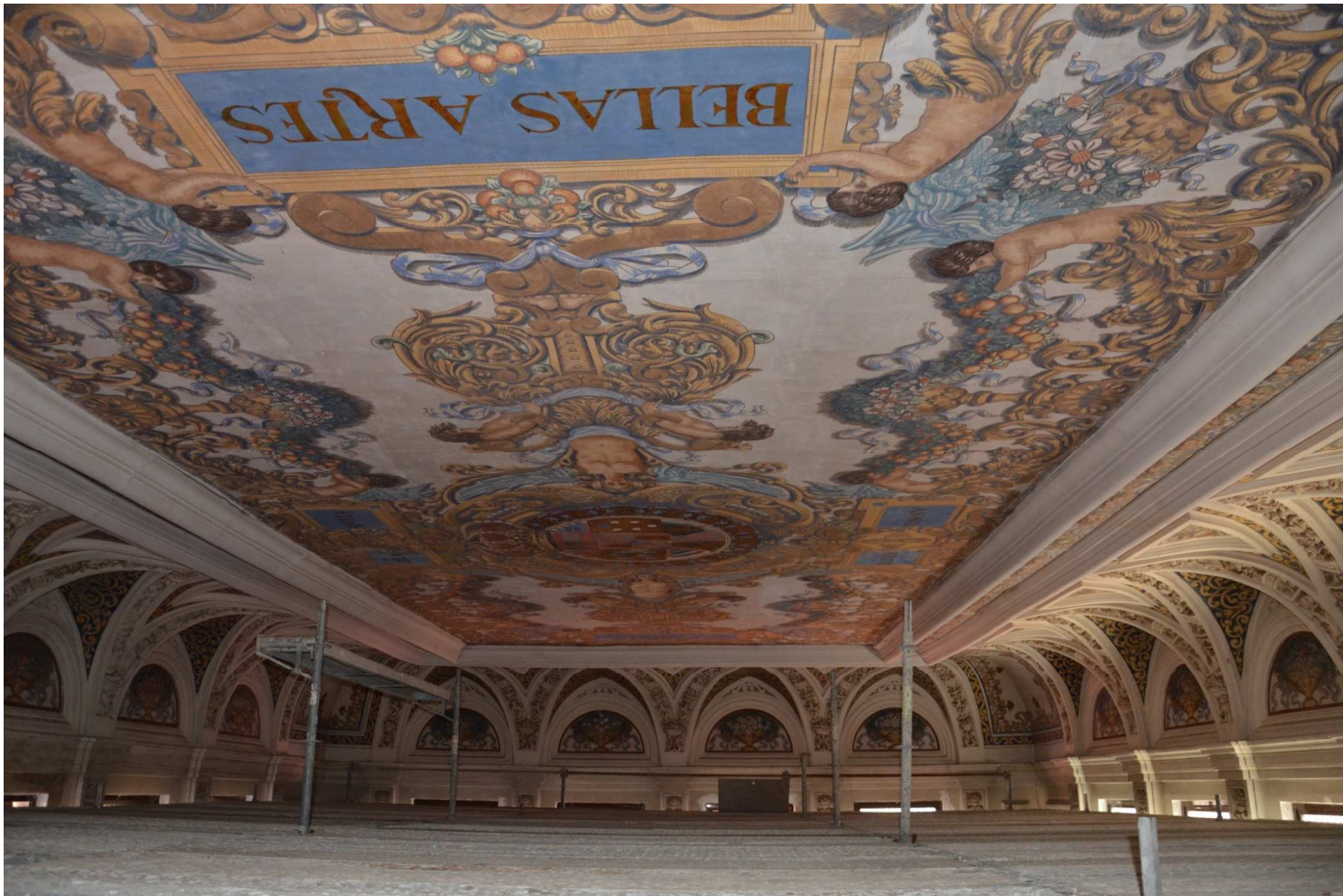
Plataforma para la restauración del techo de la escalera principal de las puertas de Castilla y León de la Plaza de España (Sevilla) Arq. Aníbal González.
